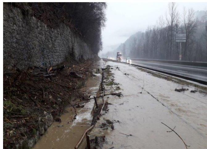
Obstruction du canal Lallier sur le secteur aval – canal sec drainant les affluents de Pallud, inondation de la voie ferrée et risques pour la RD1212
