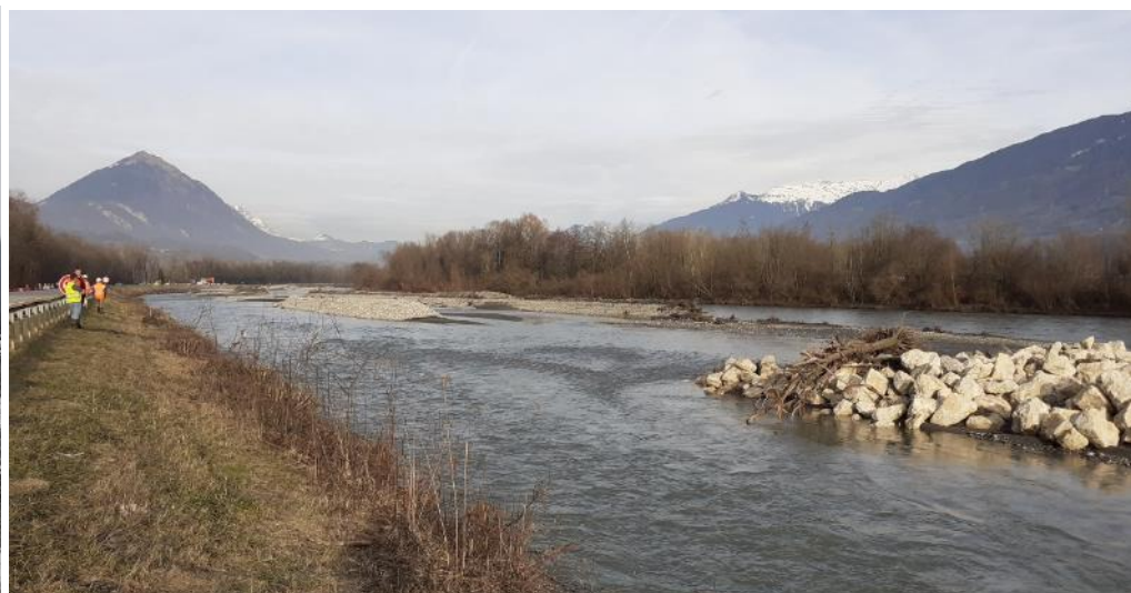
Batardeau du chantier digue à Montailleir détruit par la crue du 29 Décembre 2021
