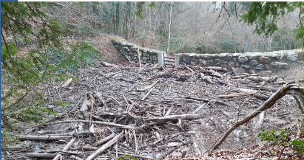
Crue du 29 Décembre 2021 – plage de dépôt du 2 ème Berre
